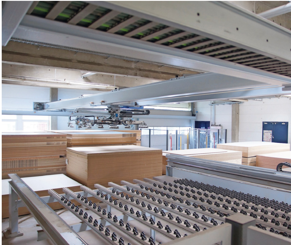
Das neue Homag-Automation-Lager mit 400 m 2 Grundfläche versorgt die Plattensäge und die Nestingmaschine. Der jährliche Durchsatz beträgt 12000 Halb- und Vollformatplatten
